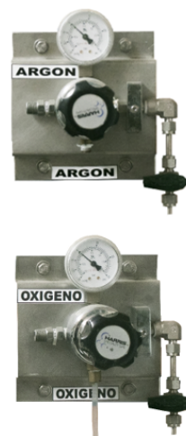
(e) Centralilla de gases
