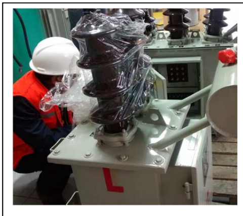
Inspección General del Transformador
